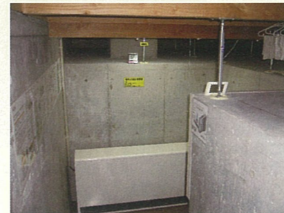
地下に設置された蓄熱暖房ヒーター
